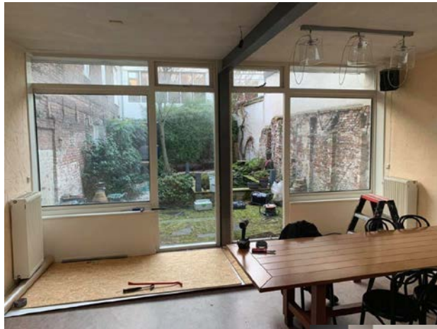
Bild 3: So sahen Küche und Garten vorher aus. Zwar gab es Glas, aber der Zugang war starr und unbeweglich. Beide Bereiche waren klar voneinander getrennt – auch bei geöffneten Türen.
